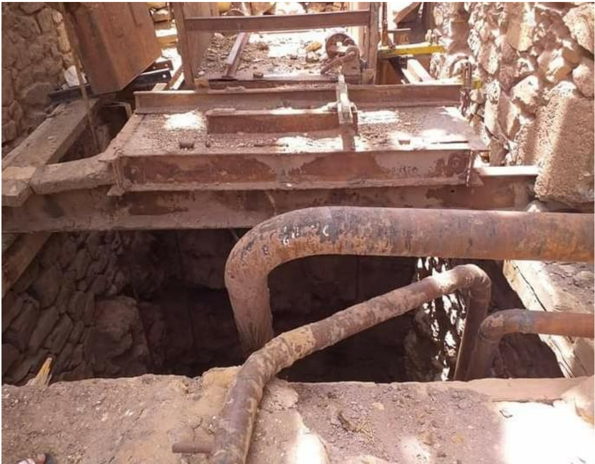
PHOTOS GISEMENT MIBLADEN SECTEUR 3 : CONDUITS D'AÉRATIONS
